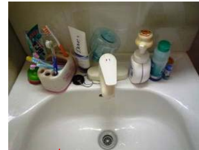
洗面室の給湯部分
